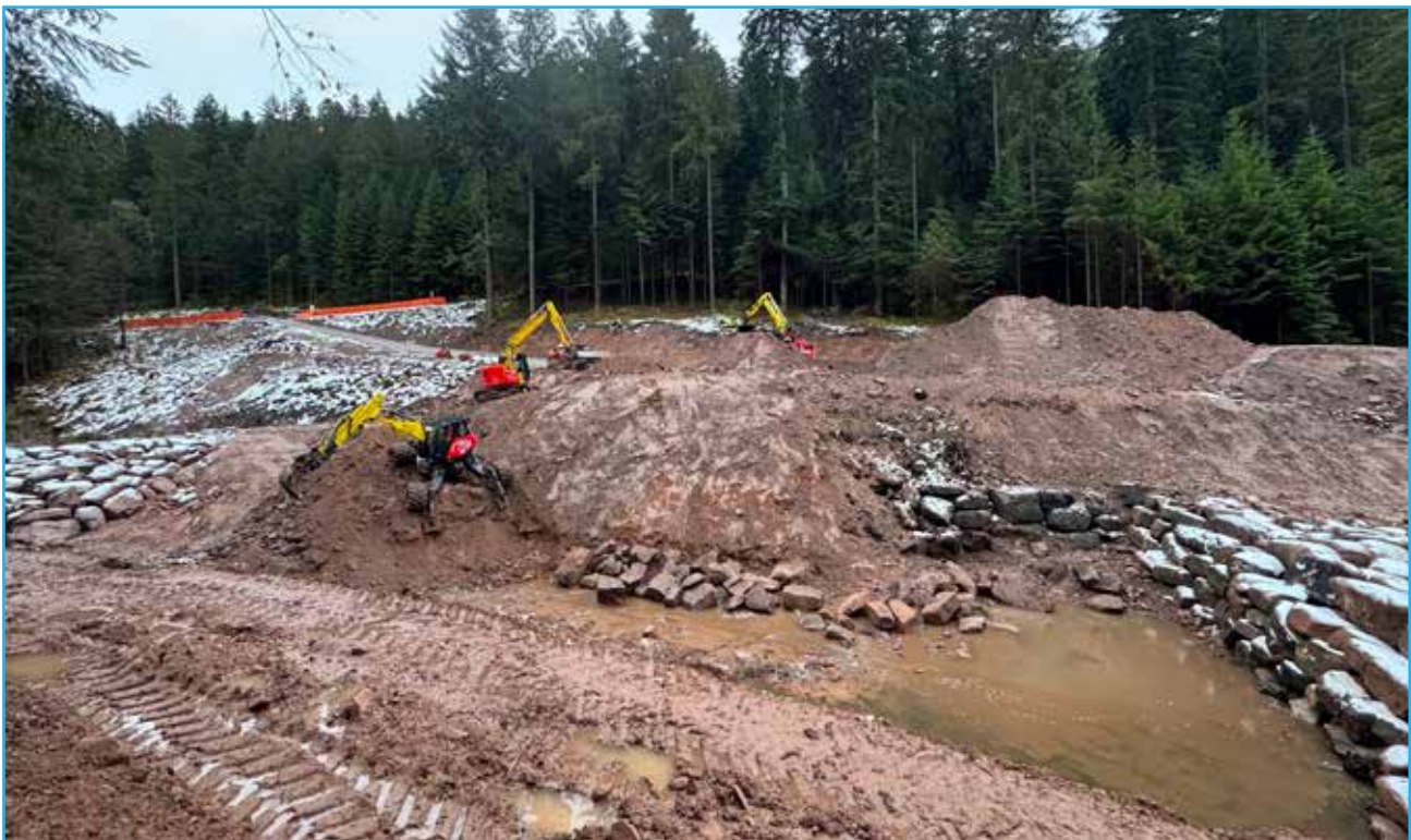
Zum Schutz der Hauptsperre, vor dem Eintrag von Sand und Geröll, ist im Zulaufbereich des Huttenbächle eine Sohlschwelle aus einer Steinschüttung erstellt. Durch das außerordentlich niedrige Talsperrenniveau 2025 fiel diese Sohlschwelle schon frühzeitig trocken, sodass sich ein ausreichend großes Zeitfenster eröffnete diese Sohlschwelle zu beräumen und in diesem Zuge neu sowie optimiert aufzubauen.
