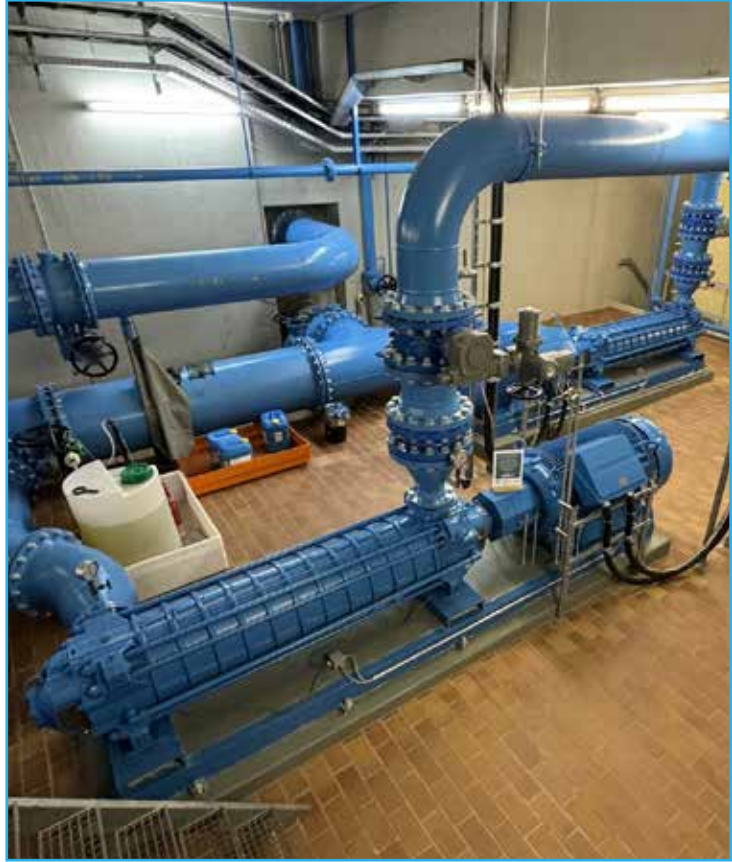
Förderpumpensätze HB/PW Winterhalde
